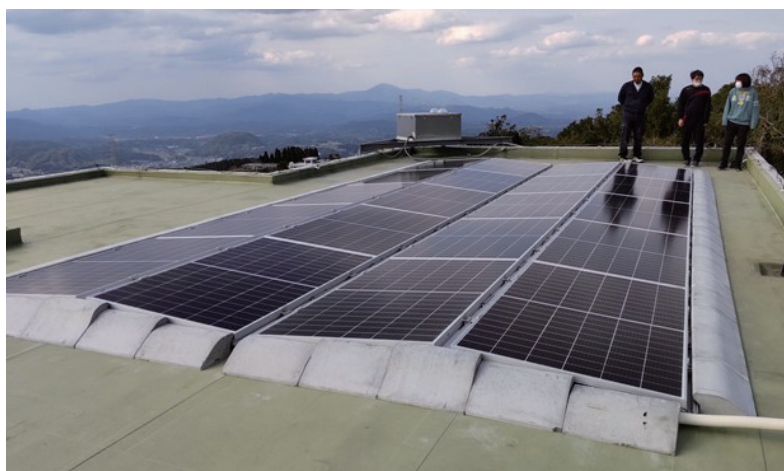
1m 望遠鏡観測棟屋上に設置された太陽光パネル
