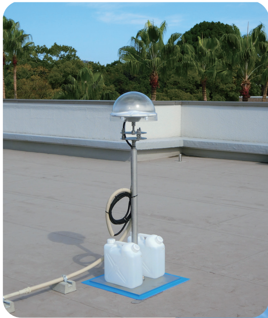
図5: 本学理学部1号館屋上に2023年11月から設置された、局所的気象現象監視ネットワーク構築用機器。
